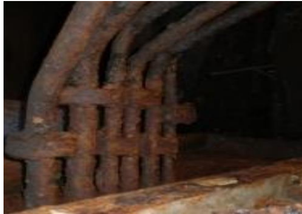
Gambar II.1 Korosi Seragam pada pipa ballast
