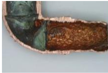
Gambar II.6 Korosi Erosi Pada Pipa
